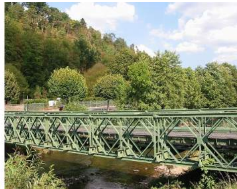
Pont Bailey sur la Meurthe, France. Pont provisoire en treillis, permettant une mise en place très rapide
