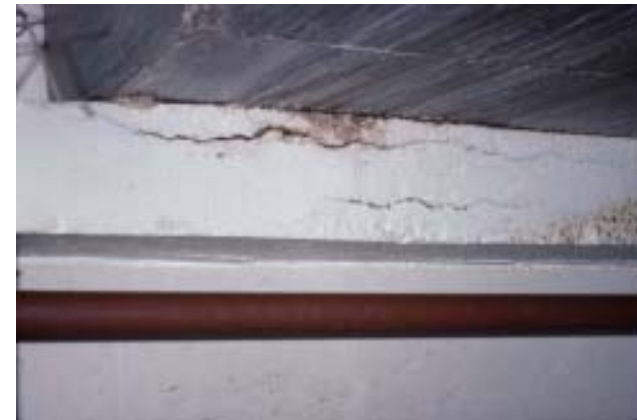
Poutre support de réservoir
