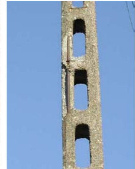
Poteau support de ligne électrifiée
