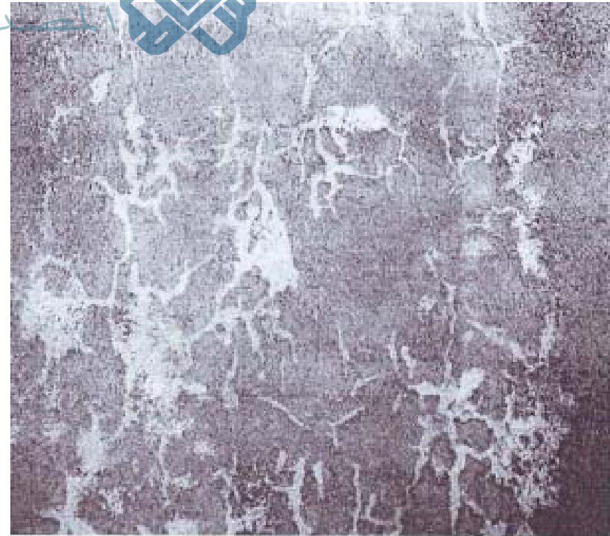
- Autocolmatage de microfissures d'enduit par dépôt de calcite.
